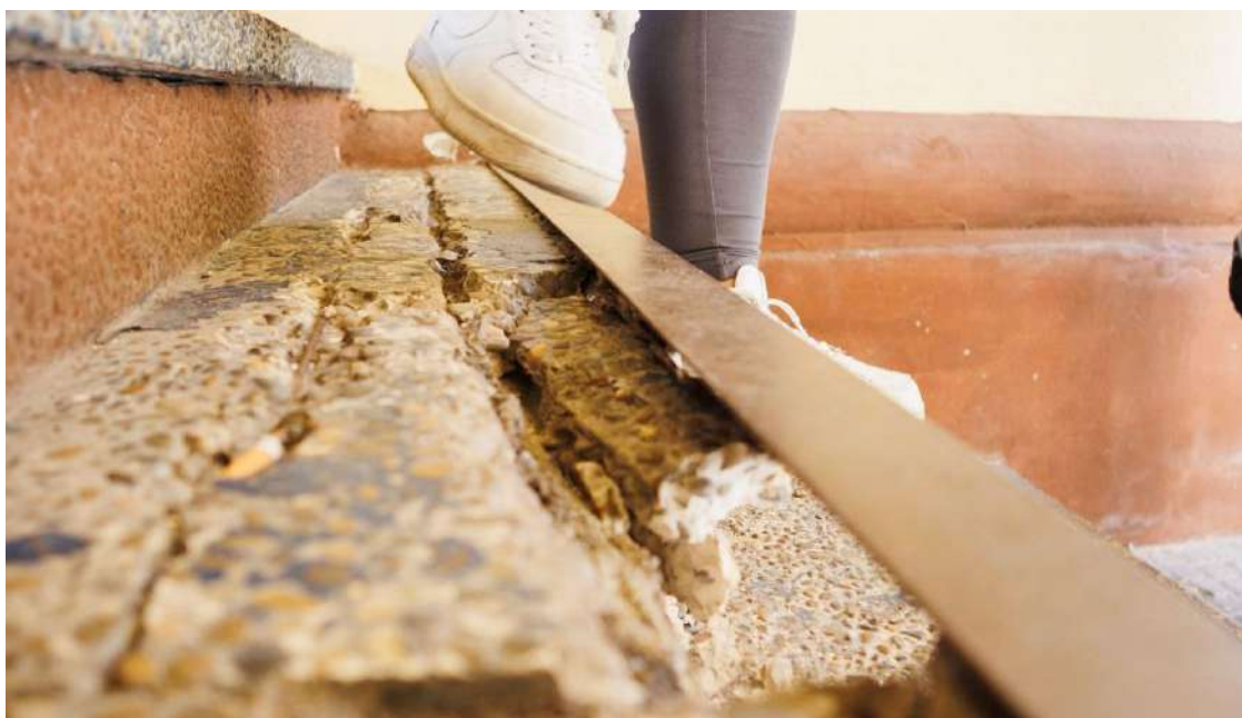
Nati advierte del peligro que presentan unas escaleras de acceso donde han sufrido caídas.
