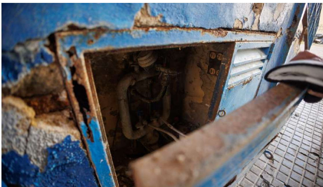
Los vecinos reclaman el arreglo de la red de tuberías. MANU GARCÍA
