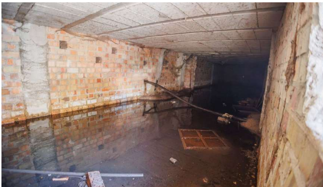
Aguas residuales estancadas en los sótanos de la barriada. MANU GARCÍA
