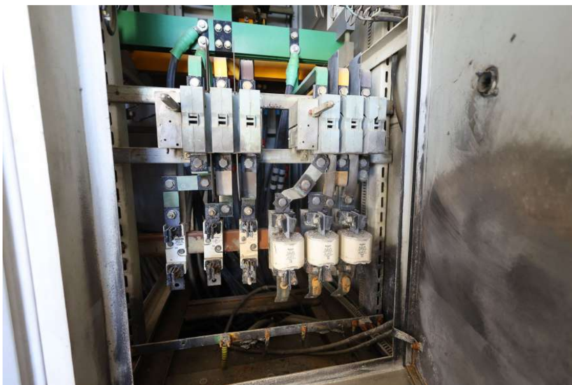
Destrozos en un cuadro eléctrico de la depuradora de El Portal debido al temporal. JUAN CARLOS TORO
